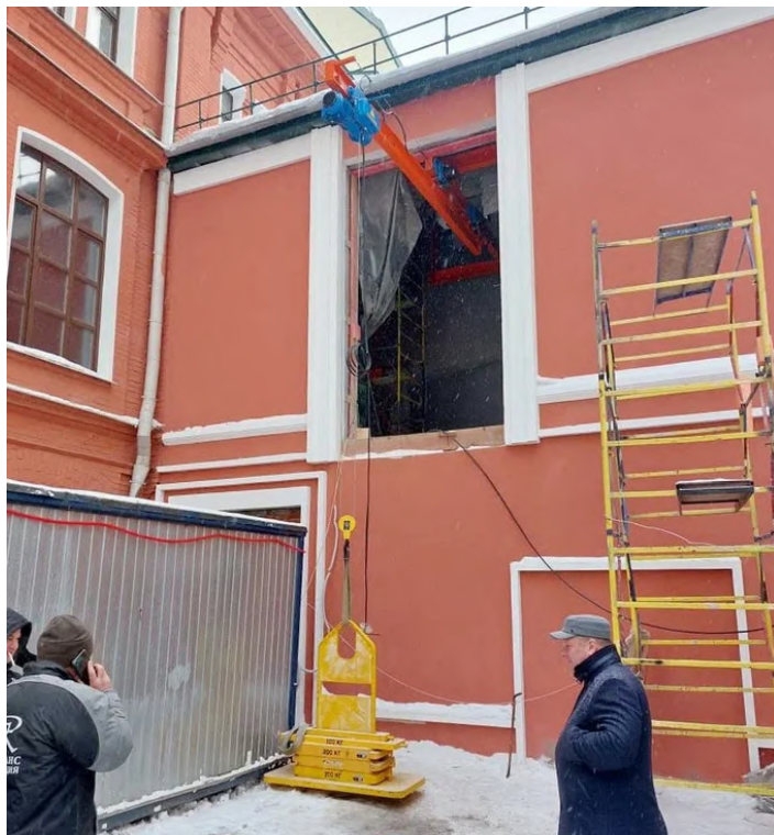
Монорельс выкатной грузоподъемностью 1,0 тонна для Московского драматического театра в г. Москве.
